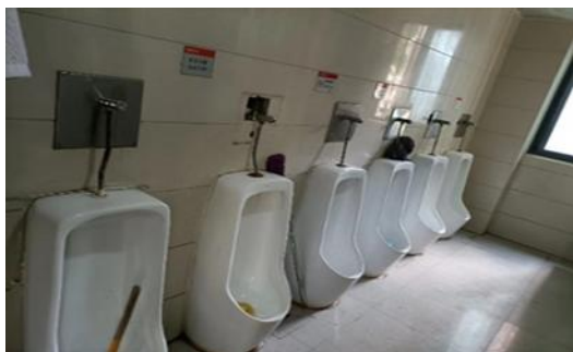
小便斗冲水阀（现状）
